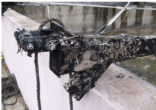
Usazovací nádrž - shrabovací zařízení
